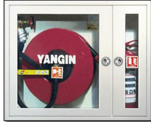
Yangın söndürme dolabı
